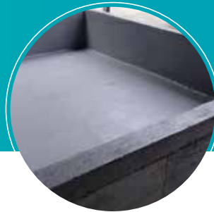
Rivestimenti protettivi tine e bacini di contenimento
